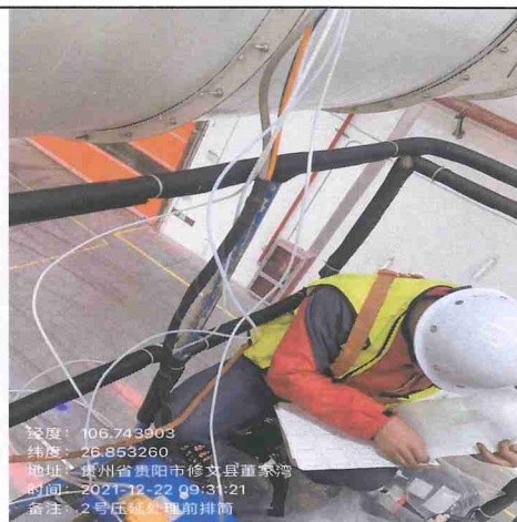
废气监测 (压延 2#处理前)
