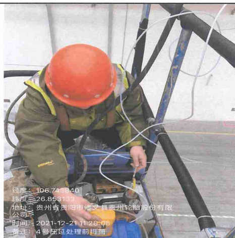
废气监测 (压延 4#处理前)
